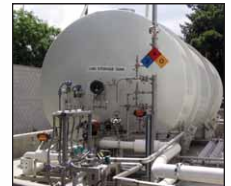
Horizontal LNG Bulk Tank
