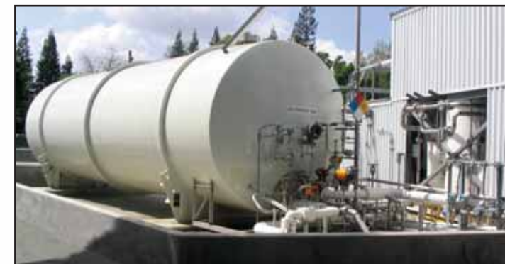
Horizontal LNG Bulk Tank
