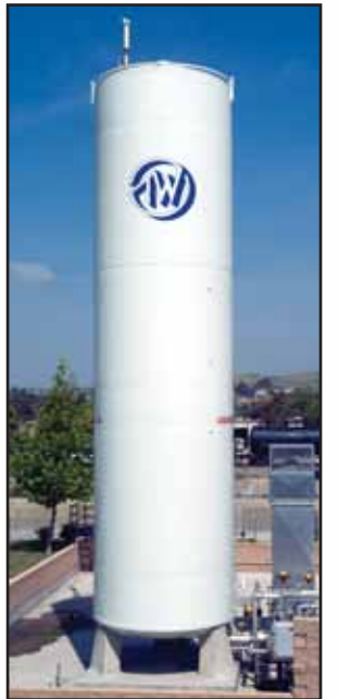
Vertical LNG Bulk Tank
